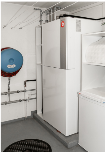
Der Kombispeicher «WKS 300/100» fand in der Waschküche Platz.
