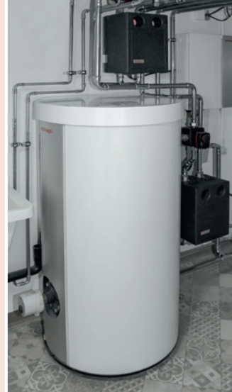
Für die Speicherung des Warmwassers hat sich der Heizungsprofi für den Pufferspeicher PSM 300 entschieden, als Trinkwasserspeicher kommt ein WAS 300 LE/Eco/B (Bild) zum Einsatz. Die kompakte Steuerung ist an der Wand angebracht und benötigt kaum Platz.
