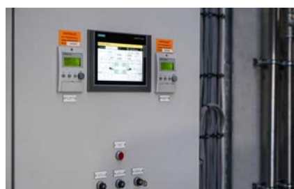
Weishaupt lieferte auch die Steuerung für die Brenner der Fernwärmezentrale.
