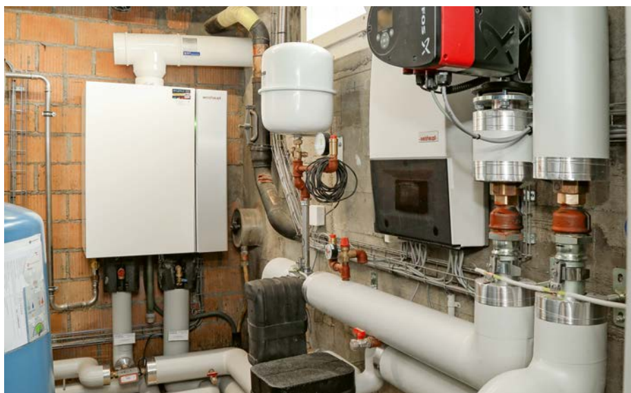
Hinten das Gas-Brennwertwandgerät WTC-GW 60-B-H von Weishaupt mit 60 kW Leistung; links der Wärmepumpenmanager mit farbigem Touchdisplay.
