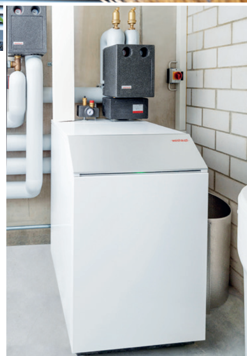
Das Innengerät ist mit einer hochwirksamen Komposit-Schallisolierung ausgekleidet und arbeitet daher extrem leise – was in diesem Mehrfamilienhaus von Vorteil ist.
