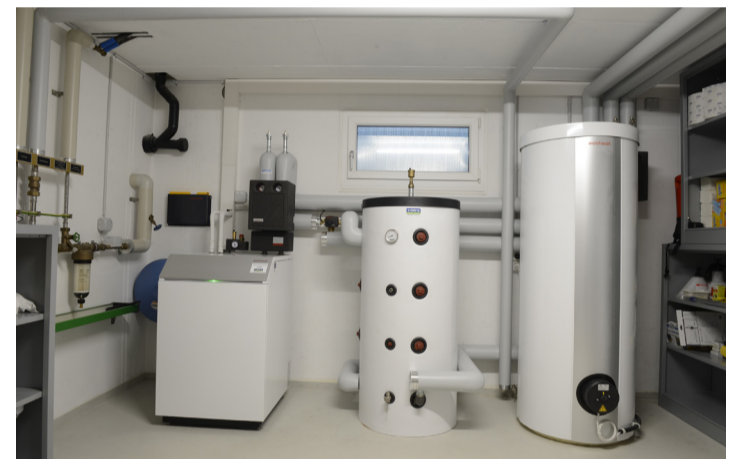
Hochwertige Materialien, robuste Bauweise und bewährte Technik sichern die Wetterfestigkeit der Anlage und den langjährigen, zuverlässigen Betrieb.
