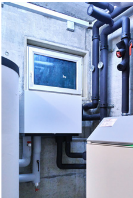
Zwischen dem Speicher links und der Geoblock-Wärmepumpe ist unter dem Fenster die passive Kühlstation untergebracht.
