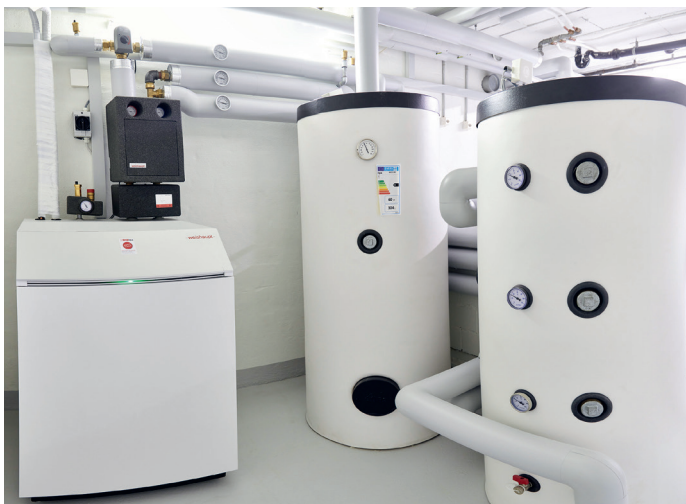
Die komplette Anlage inklusive Pufferspeicher und Warmwasserspeicher versorgt im Einfamilienhaus alles, und zwar vom Heizkörper bis zur Fussbodenheizung.
