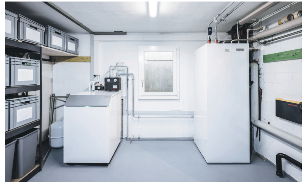
Im Einfamilienhaus der Familie Latzel/Arnold finden die Anlagen – links die Wärmepumpe, rechts der Speicher – bestens Platz.
