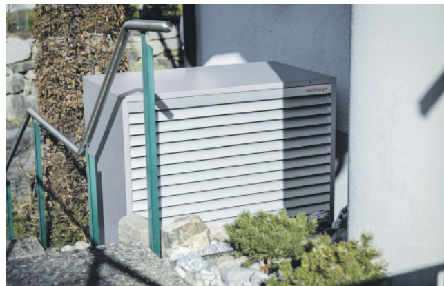
Wunderbar neben einem Aufgang ist das flüsterleise Aussen-gerät platziert.
