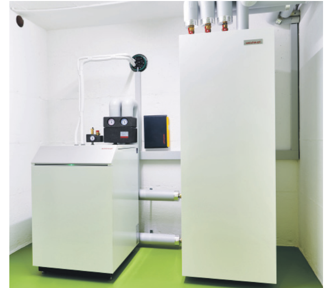
Im Einfamilienhaus der Familie Keller fand die optisch klar gegliederte Anlage trotz enger Raumverhältnisse perfekt Platz.
